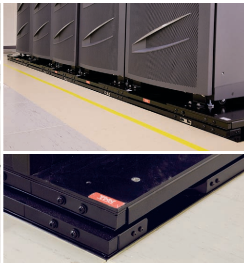
JAL免震サーバー
