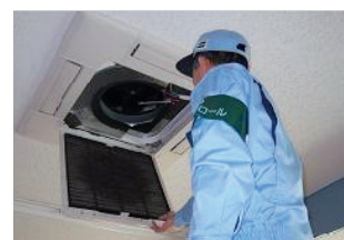
組立室空調フィルタの点検
