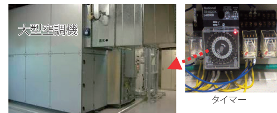
回転速度を変換するタイマーを制御盤に取り付けました。
