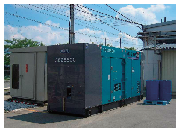
甲府工場に設置した発電機
