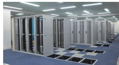
免震サーバー室の床全面に免震装置を採用
