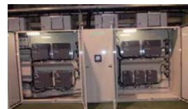
インバーター制御盤
