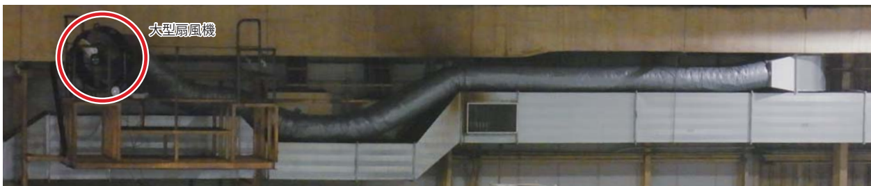
排熱を工場内に送り込む大型扇風機
