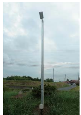
駐車場に設置されたLED照明灯
