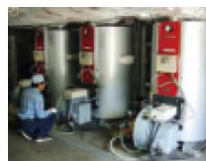
山口工場 ボイラー
