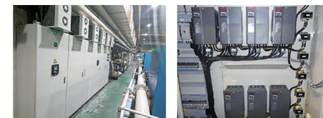
第3工場の集中クーラント装置にインバーター用制御盤を導入
