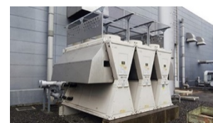
小型冷房設備の活用（岐阜工場）
